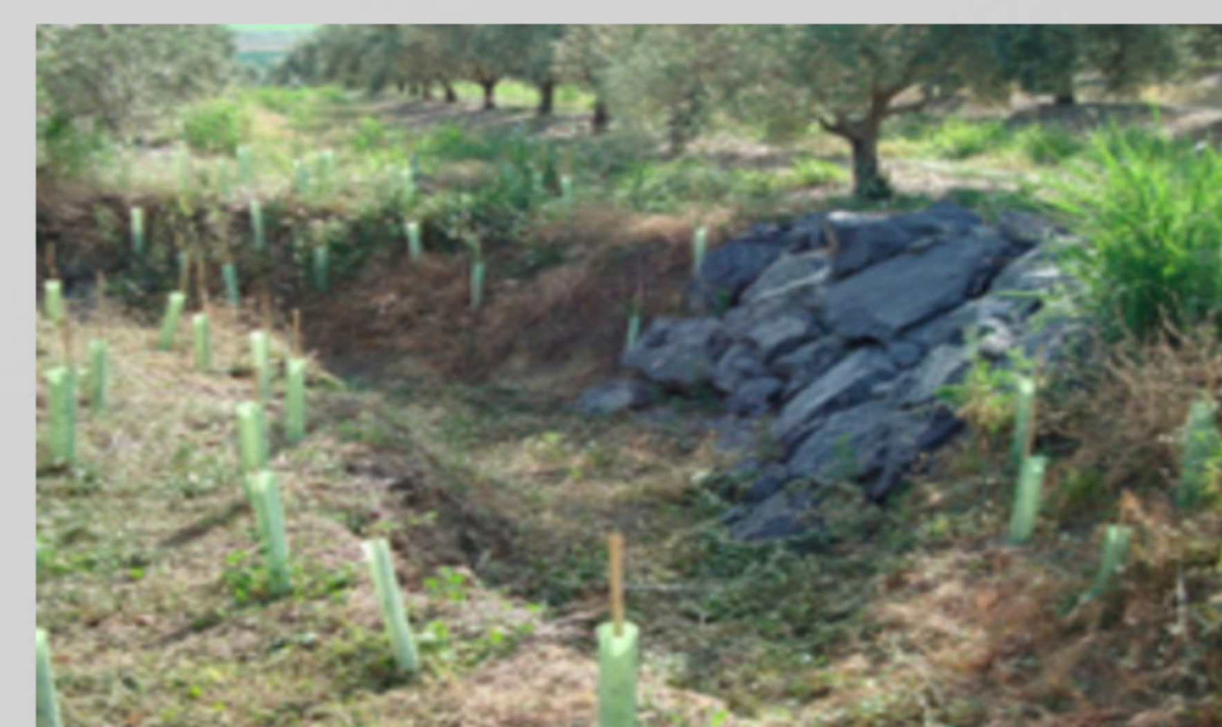
Detalle de estabilización de cárcava en zona agrícola. Córdoba. (Fuente: Miguel Ángel Fernández Carrillo).
